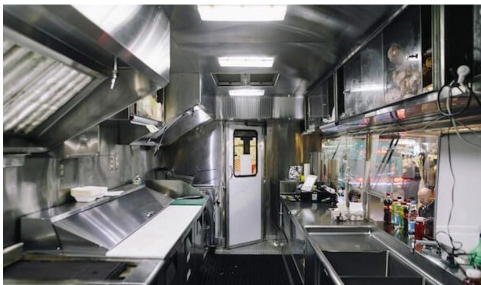
Рис. 3.2. Внутреннее оборудование фудтрака
